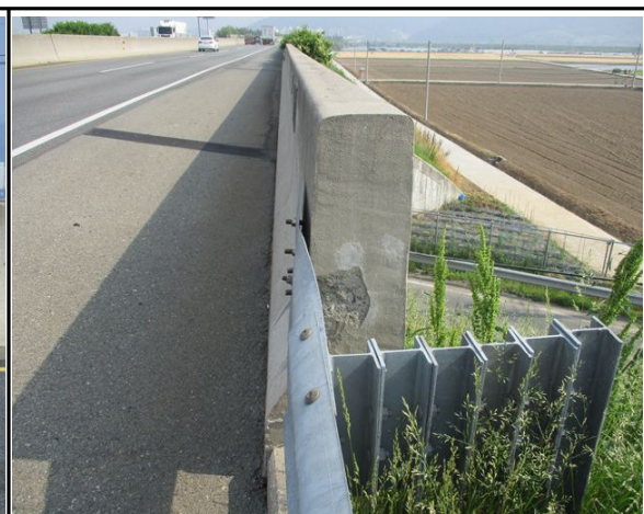
상행선 콘크리트 박락
