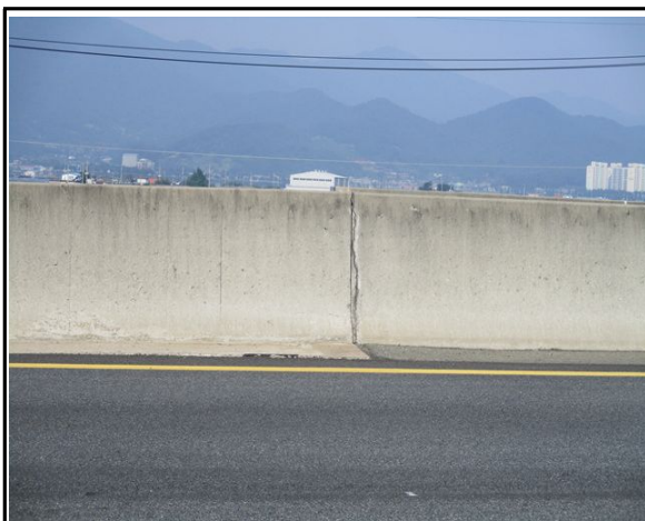
상행선 중분대 균열
